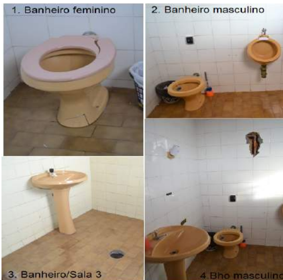
Foto 2 - Parte hidráulica e sanitários
